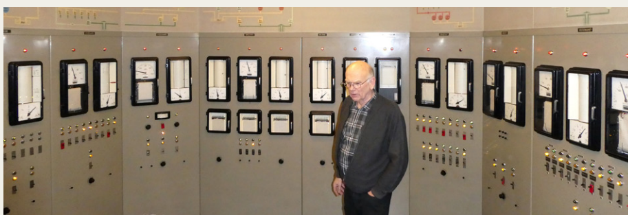
Det gamle kontrolpanel, hvorfra alle vandværker og vandtårne kunne overvåges og styres. I dag foregår det hele på computer.
