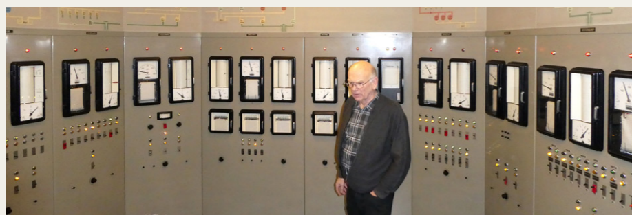
Det gamle kontrolpanel, hvorfra alle vandværker og vandtårne kunne overvåges og styres. I dag foregår det hele på computer.
