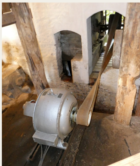
Fra 1921 til 1995 trak vandmøllens turbine en jævnstrømsdynamo, som leverede 110 Volt jævnstrøm til lamper i Møllegårdens stuehus og udbuse. Samtidig blev 55 åbne 2 Volt syrecellebatterier opladet, så, der også var strøm til rådighed, når møllen var stoppet.
